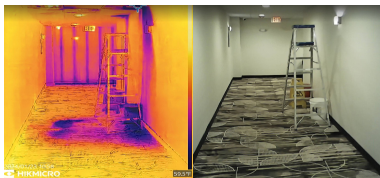
Détection des fuites d'eau
